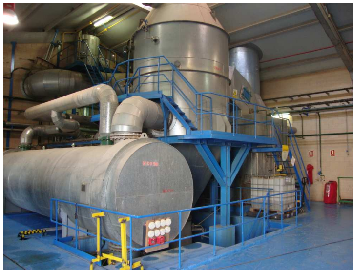
Figura 13. Vista de la instalación para el tratamiento térmico
