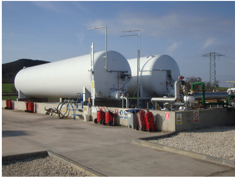
Figura 14. Depósitos donde se almacena el GLP que será quemado en los motores de explosión para la cogeneración
