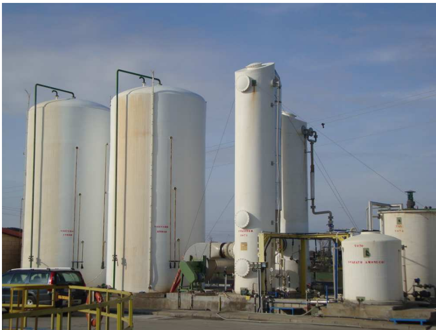
Figura 15. Sistema que lleva a cabo el Stripping y tanques T089 (depósitos stock)
