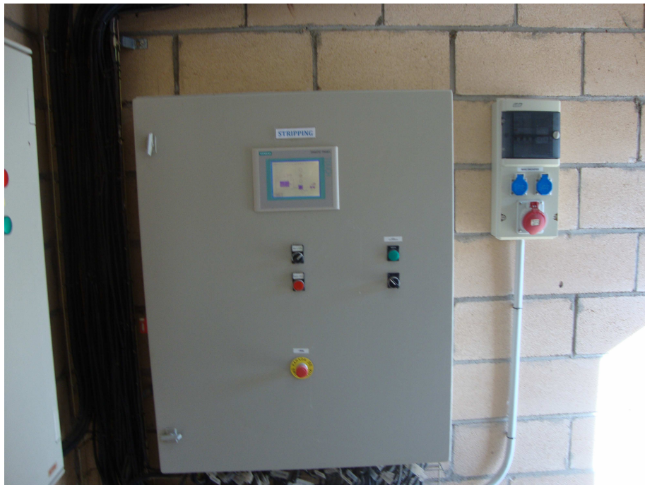
Figura 18. Cuadro de control del Stripping
