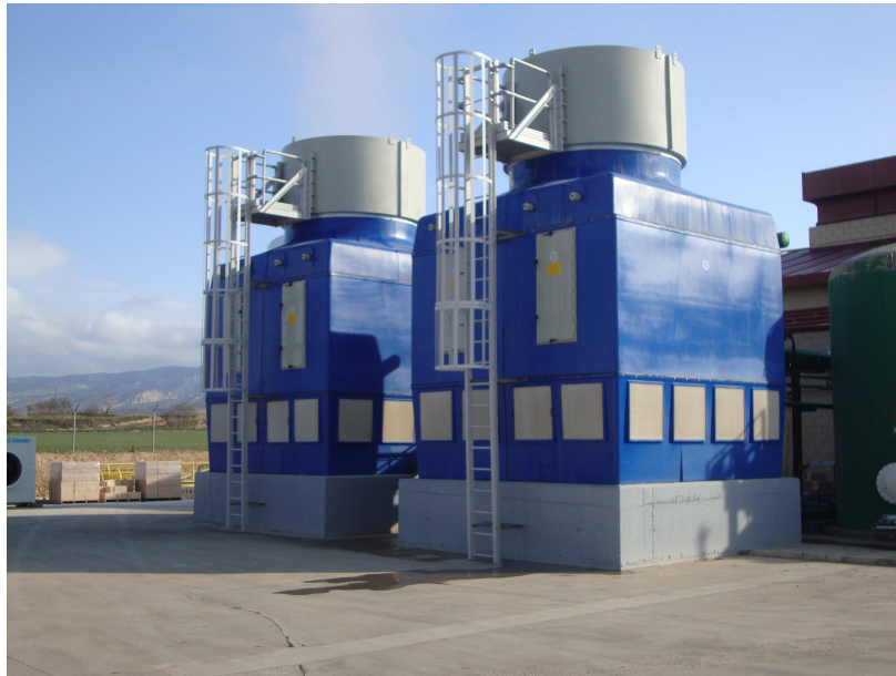
Figura 16. Torres de refrigeración
