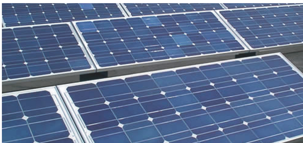
Fig. 7.1 Paneles fotovoltaicos, pueden apreciarse los huecos entre las células
