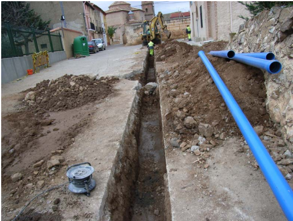
PK 0+435. Punto de conexión a la red general. Calle Pilar Bayona.
