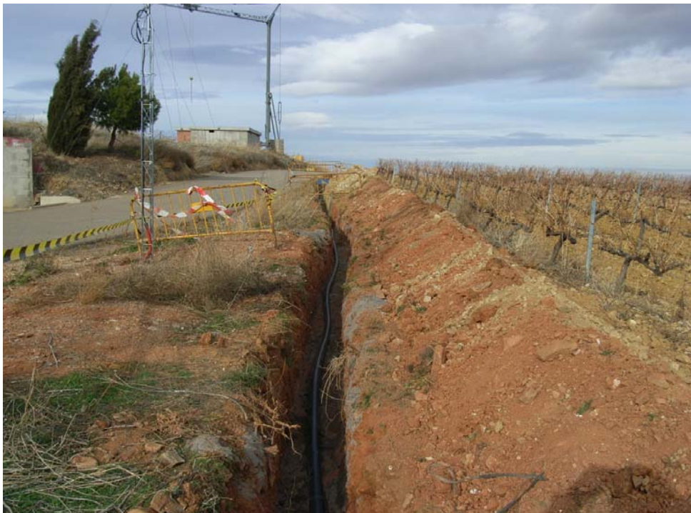
Tubería de conexión de la distribución del nuevo depósito a la del existente.
