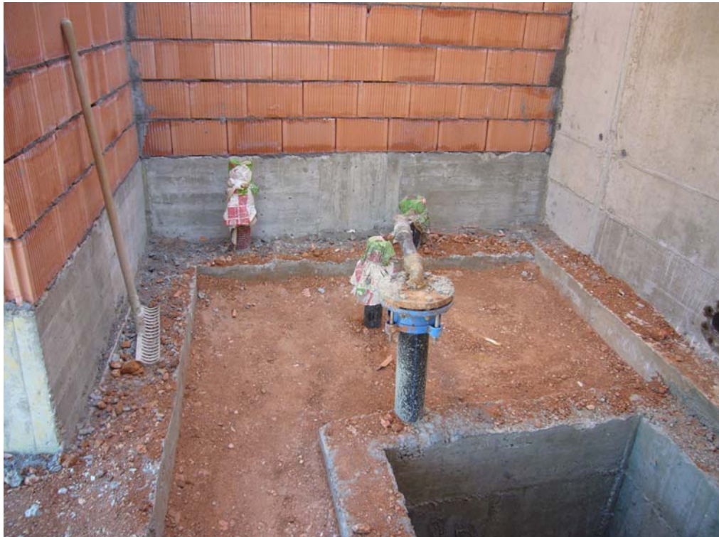
Tubo de conexión eléctrica (rojo), entrada impulsión (junto pared), entrada manantial (delante), salida de distribución (embridado) foso de desagüe.
