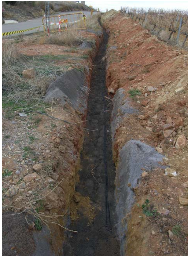
Cables de control de sondas y energía para en nuevo cuadro de control.
