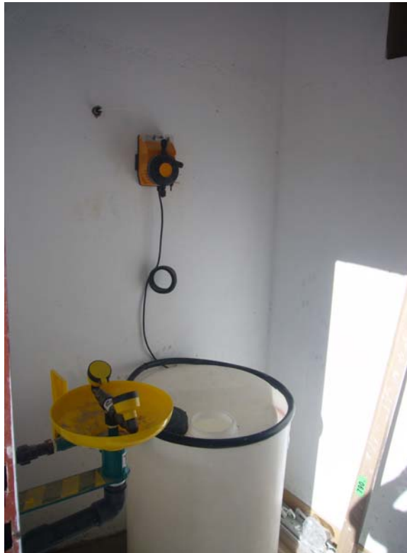
Bomba de hipoclorito, depósito de 250 l. y lavajos en depósito nuevo.
