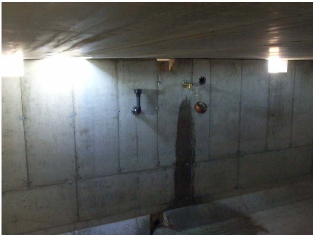
Equipación del vaso: Aliviadero, toma de distribución (abajo), válvula flotador.
