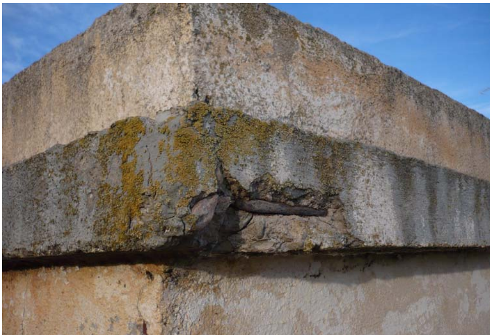
Los ciclos de heladas y desheladas levantan el recubrimiento dejando las armaduras a la vista.
