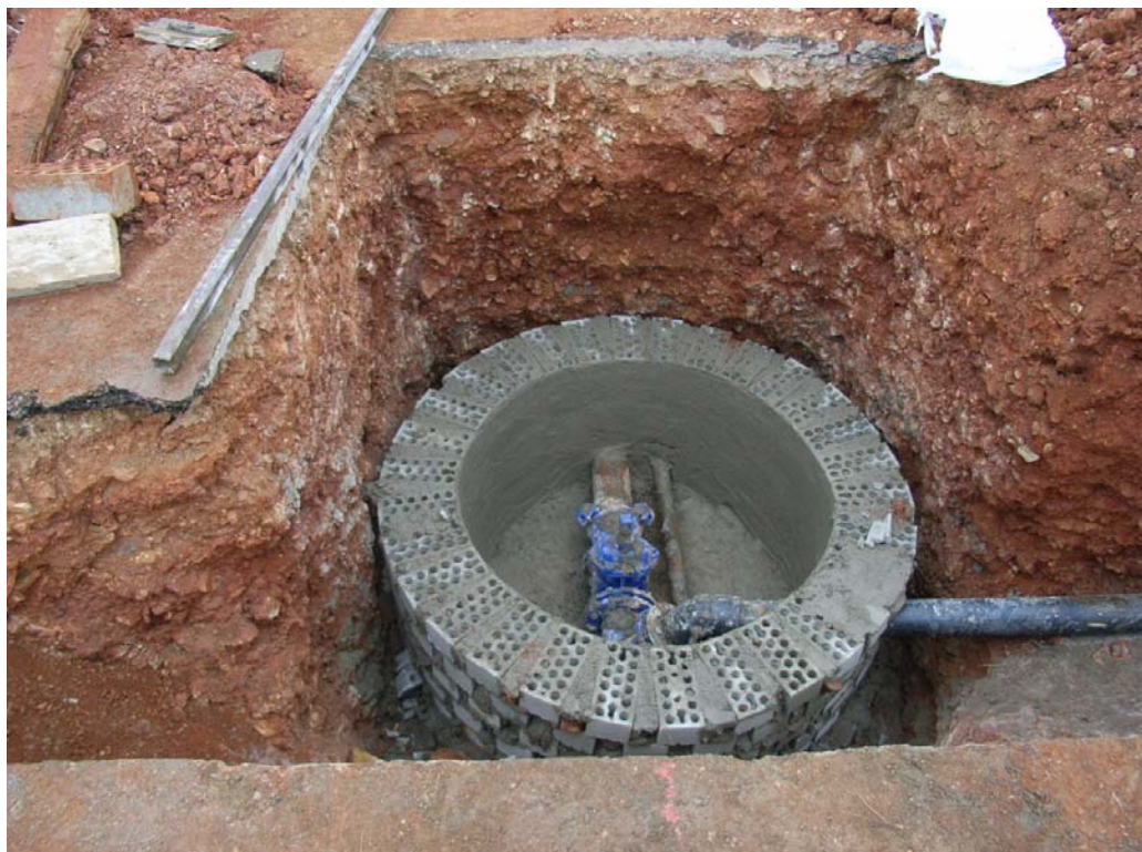
Arqueta de conexión del nuevo depósito a la impulsión.
