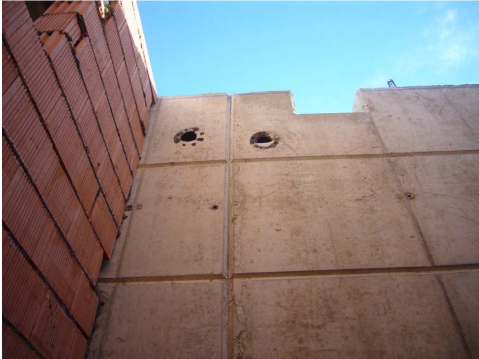
Pasamuros de los abastecimientos, el del sondeo y los de los manantiales.
