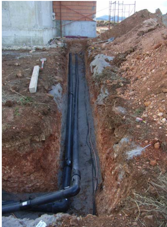
Tuberías de interconexión y cableado (energía, sondas y toma de tierra).
