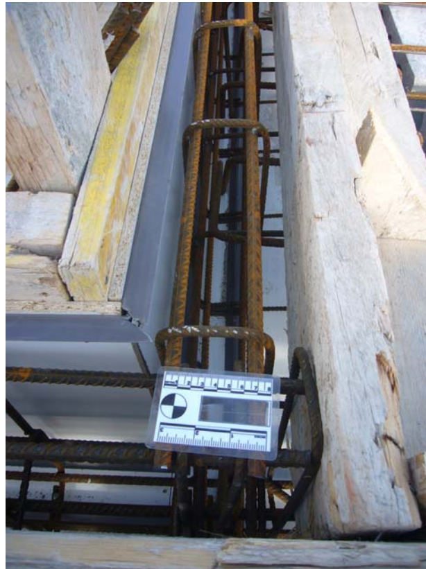
Detalle de zuncho perimetral que forma la imposta y recoge los vierteaguas.
