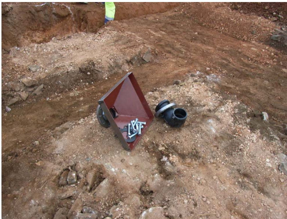
Desagüe de fondo del depósito.
