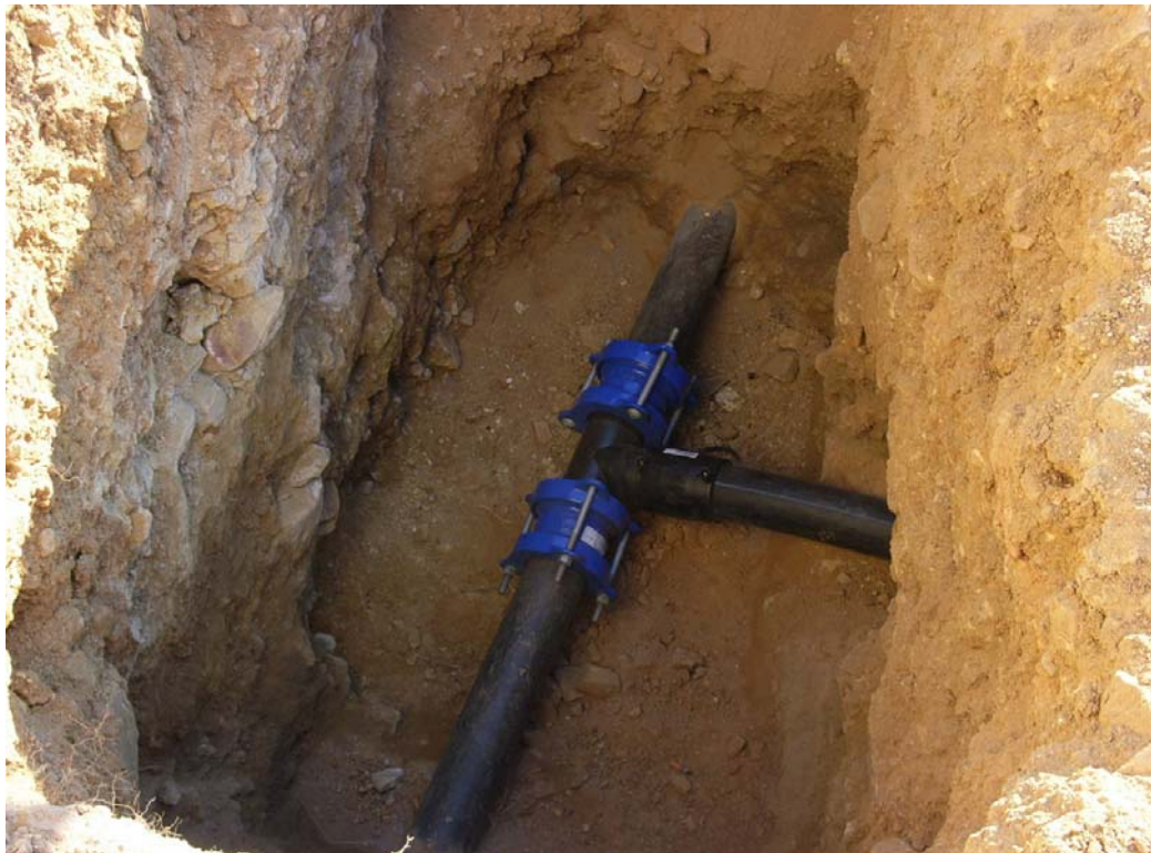
Conexión de la distribución del nuevo depósito a la distribución del existente.
