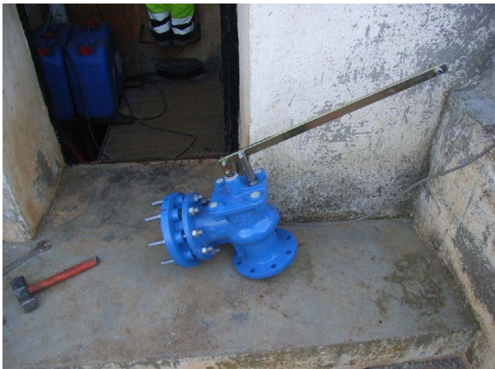
Nueva válvula de flotador para el depósito existente.
