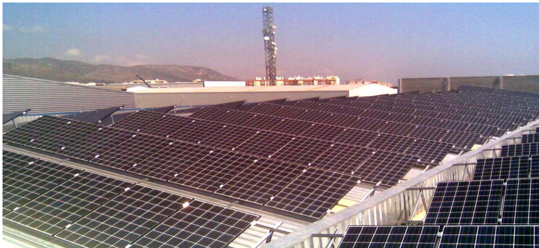
Figura 1: ejemplo de una instalación solar en nave industrial.
