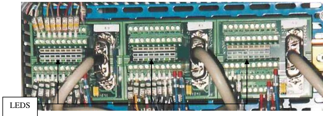
Fig. 161: Módulos Precableado Estación 1
