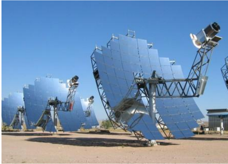
Fig. 1: Planta de demostración de Maricopa, Arizona.
