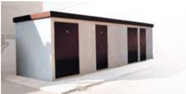
PF-203 con 2 transformadores y PF-201 para contadores
