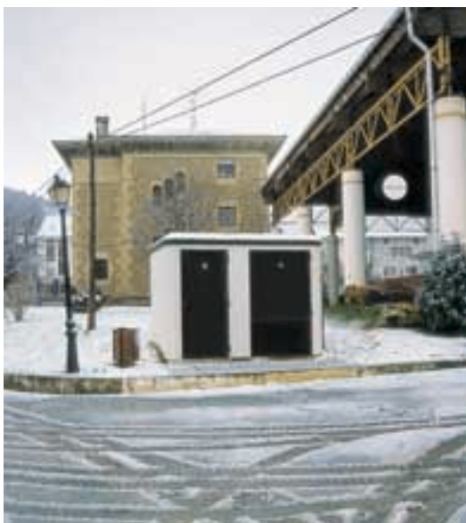
PFU-3 con 1 transformador
