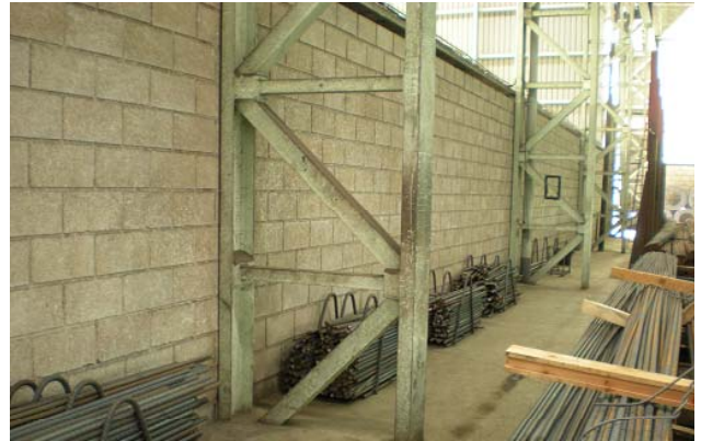
Casilleros para recoger los picos de ferralla
