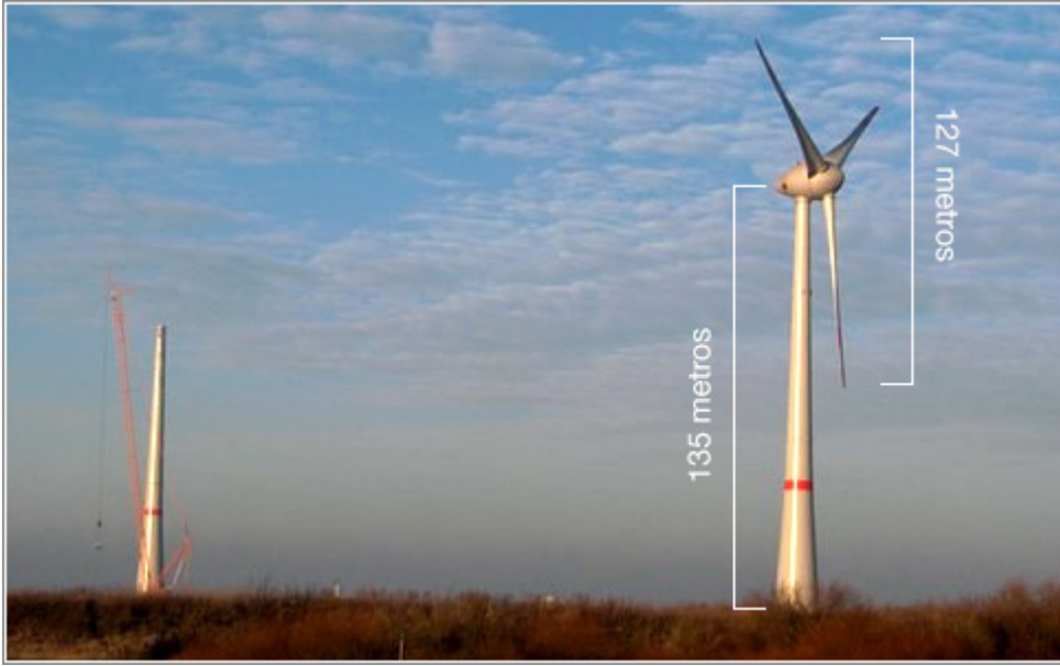
Fig 4. 12 Aerogeneradores para suministrar electricidad a 5.000 hogares
