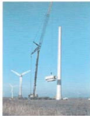
Fig. 3. 28 Aerogenerador con torre tronco-cónica
