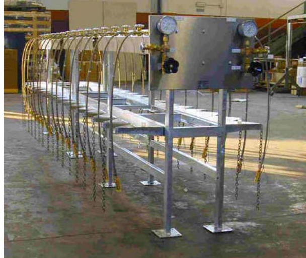
Figura 56- Rampa con dos líneas de llenado independientes. [73]
