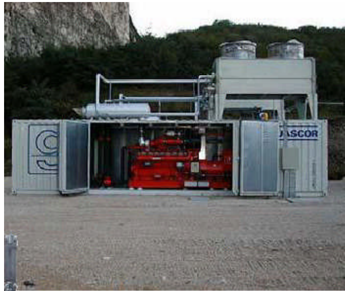
Figura 37- Solución conteinizada de motorización. [11]
