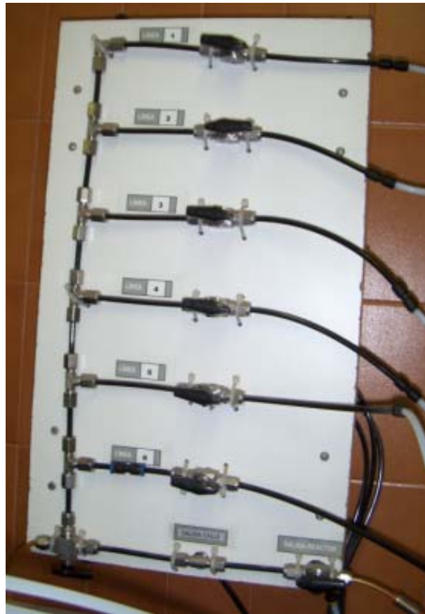
Imagen B.5 Panel de válvulas de tres vías.
