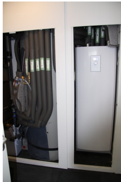
Bild 6 - Värmepump i groventré
