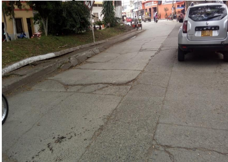
Figura 27 Losas pavimento rígido fracturadas (socavamiento)
