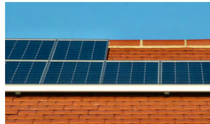
Paneles fotovoltaicos en techumbre
