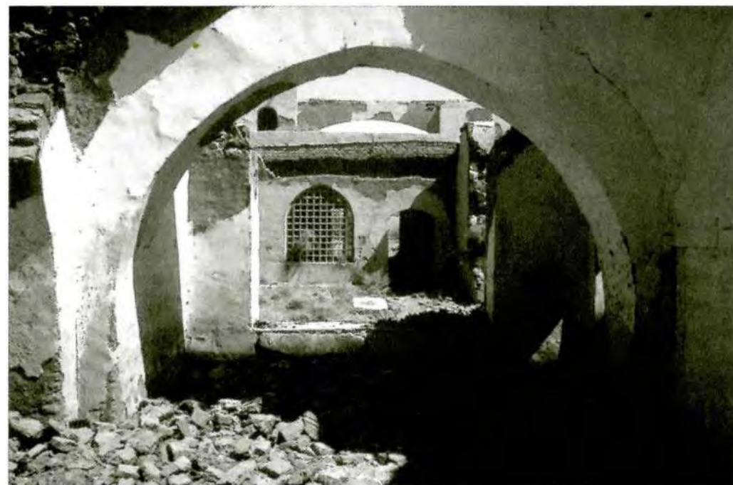
Figura 8. Arco, daños. Fuente Aga Khan Trust for Culture. IHF0154.
