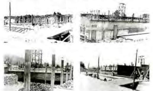
Escuela para la Industria Textil. San Miguel Ameyal-co. Obras para la provisión de agua potable. 1951.
