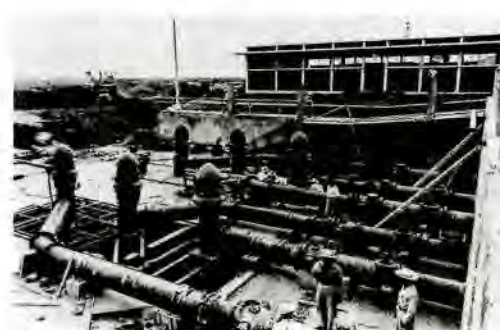
Bombas para elevar el agua al Acueducto. Obras para la provisión de agua potable. 1951.
