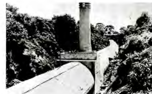
Ventila en el acueducto circular de Tlaxcaltenco. Obras para la provisión de agua potable. 1951
