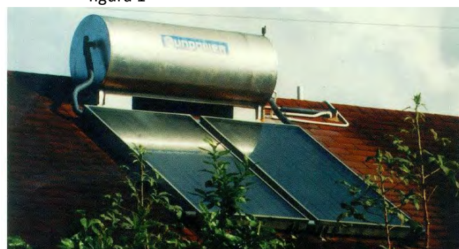
Captadores solares con tanque horizontal
