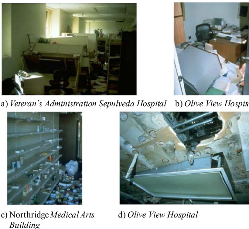
Figura 1.11 Daño en contenidos e instalaciones en distintos hospitales durante el sismo de Northridge en 1994 a) Veteran's Administration Sepulveda Hospital , b) Olive View Hospital , c) Northridge Medical Arts Building , d) Olive View Hospital (daño en instalaciones), fotografías: NISEE http://nisee2.berkeley.edu/
