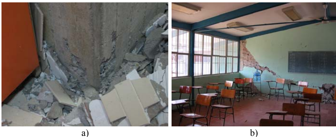
Figura 1.12 Daño en estructuras esenciales ubicadas en la ciudad de Colima producido por el sismo de Tecomán a) Hospital Dr. Miguel Trejo Ochoa del ISSSTE b) Escuela primaria Ixtlahuacan, fotografías adaptadas de Alcocer et al., 2003
