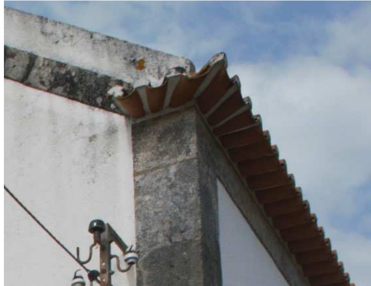
Figura 95. Estado do beirado saliente visível pelo exterior
