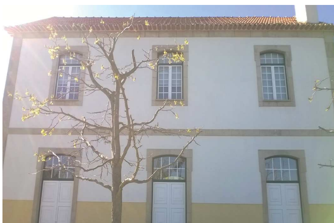
Figura 53. Alçado atual do equipamento central da antiga estação de Sabugosa com substituição de todas as caixilharias exteriores pré-existentes em madeira por PVC
