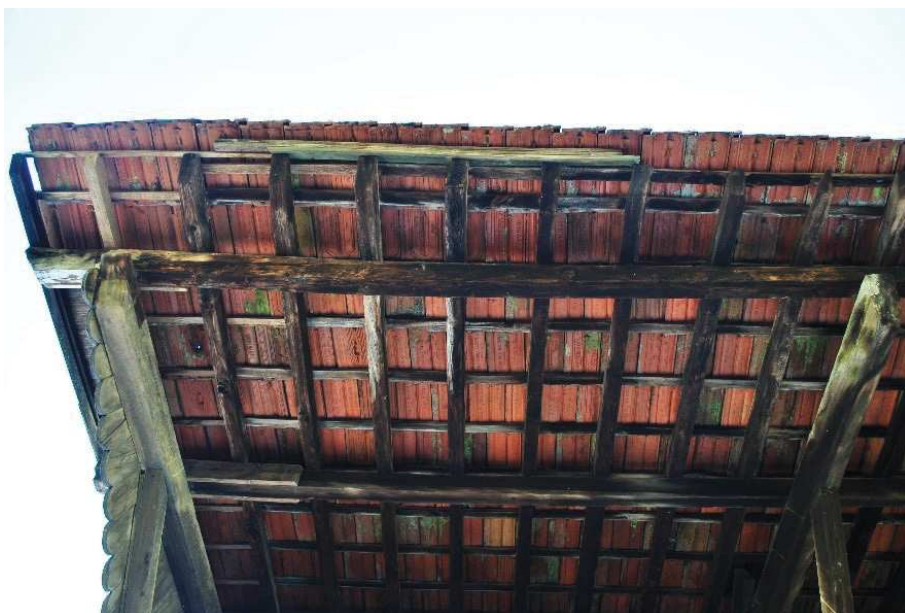
Figura 98. Surgimento de fungos e fissurações nas telhas
