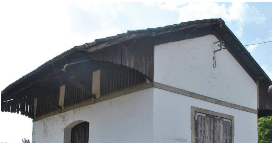
Figura 97. Degradação da cobertura do volume de armazém
