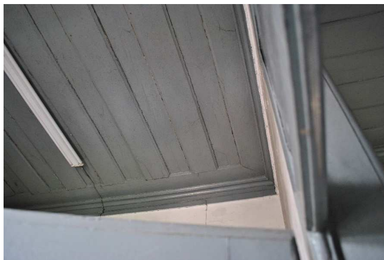
Figura 93. Estado do teto interior do piso superior
