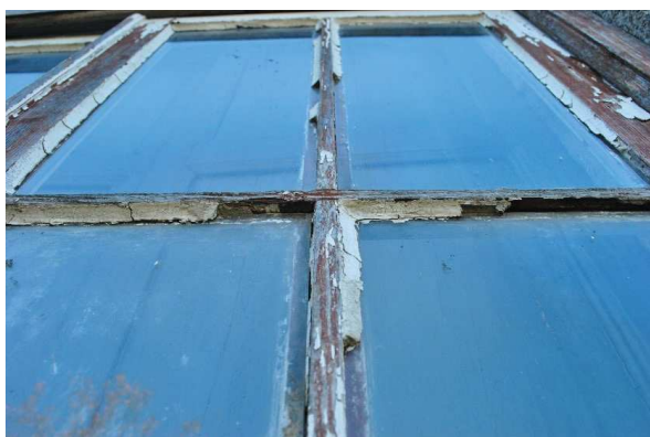
Figura 104. Pormenor de vedante a descascar na envolvente dos vidros
