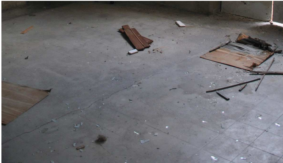
Figura 89. Fissuração no pavimento térreo
