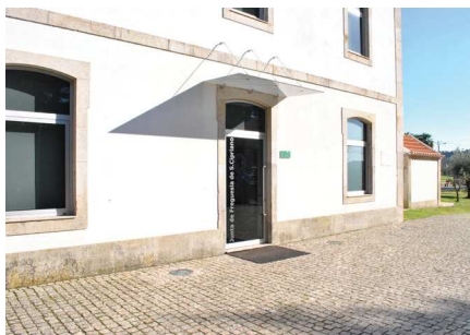
Figura 12. Fachada atual da antiga bilheteira com caixilharias em alumínio lacado branco, atualmente usado como junta de freguesia
