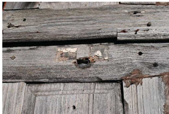
Figura 105. Estado de degradação de porta de acesso
