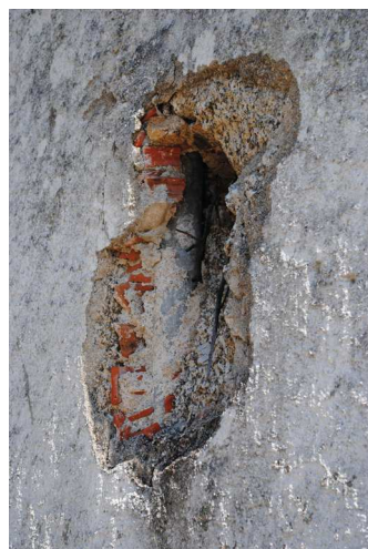
Figura 73. Pormenor de fissura pelo lado exterior de parede com tubagem de esgoto no interior
