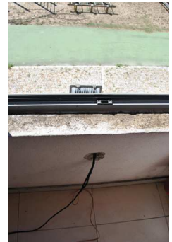
Figura 45. Pormenor de passagem de cabo elétrico para iluminação exterior
