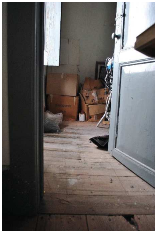
Figura 90. Estado do pavimento superior com ondulações e fissurações
