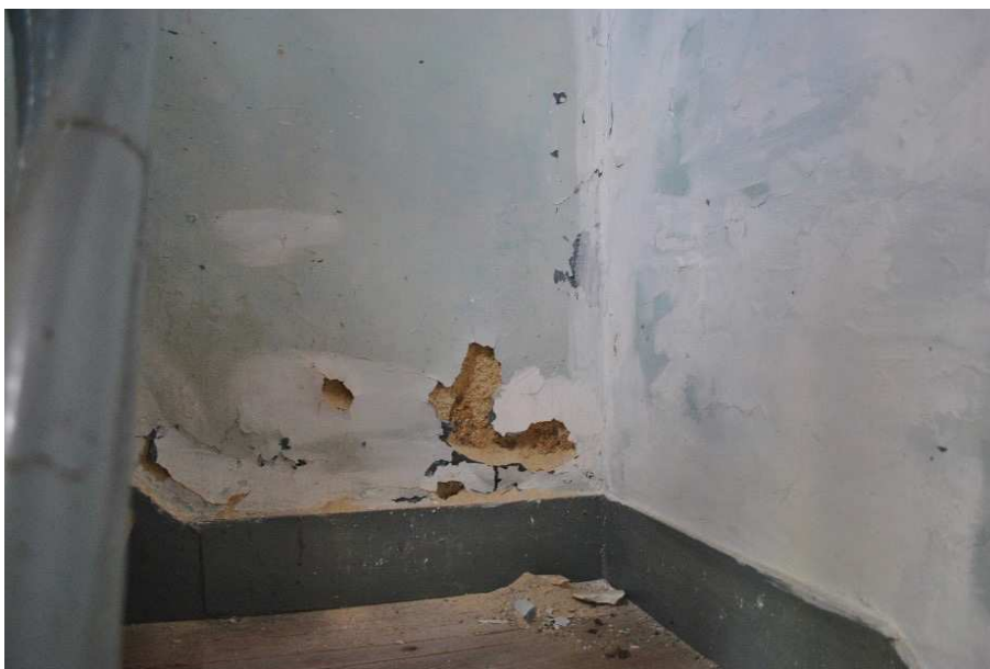
Figura 87. Parede interior com saibro e gesso a desfazer-se
