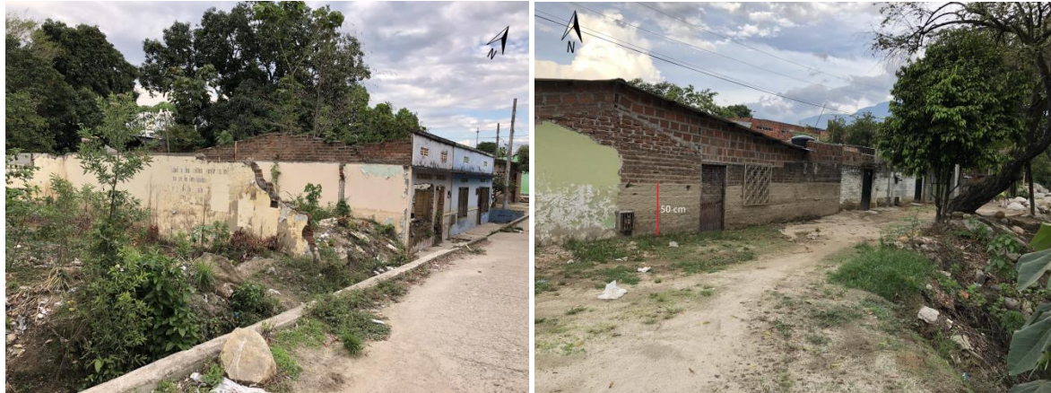
Figura 114. Afectación del casco urbano de Campoalegre durante el evento
