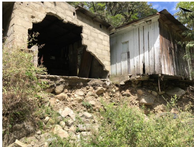
Figura 112. Afectación a vivienda rural durante el evento del 2003. Ubicada en la zona de amenaza alta.
