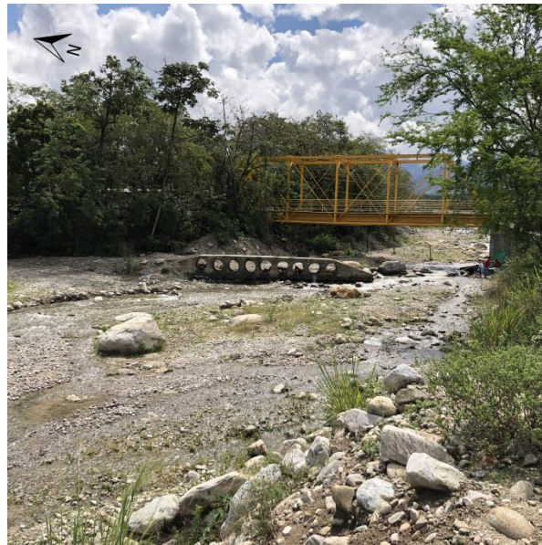
Figura 116. Afectación al puente intermunicipal
