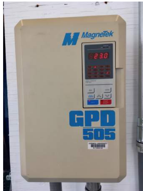
Figura 3.5: Variador de frecuencia del ventilador.
