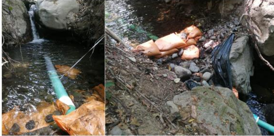
Figura 5.6. Captación Agua superficial Río Guarial
