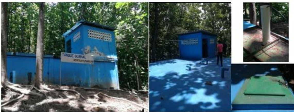
Figura 5.8. Tanque de almacenamiento Guarial
