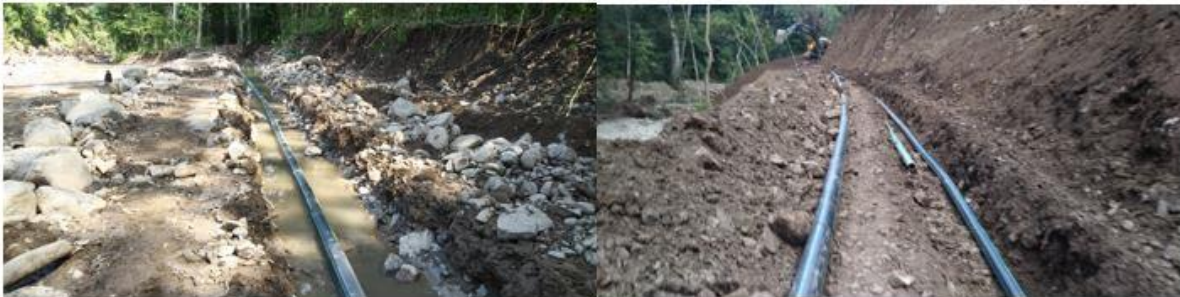
Figura 5.16. Línea de conducción Naciente El Tigre a TA Guarial durante la rehabilitación Fuente: (R., Arias comunicación personal, 10 de diciembre, 2018).
