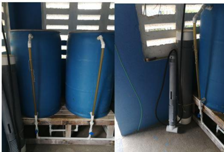
Figura 5.12. Sistema de cloración del pozo Cuchillo
