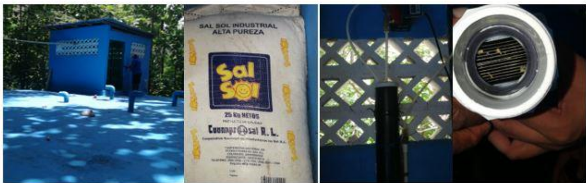
Figura 5.11. Sistema de cloración del tanque de almacenamiento Guarial
