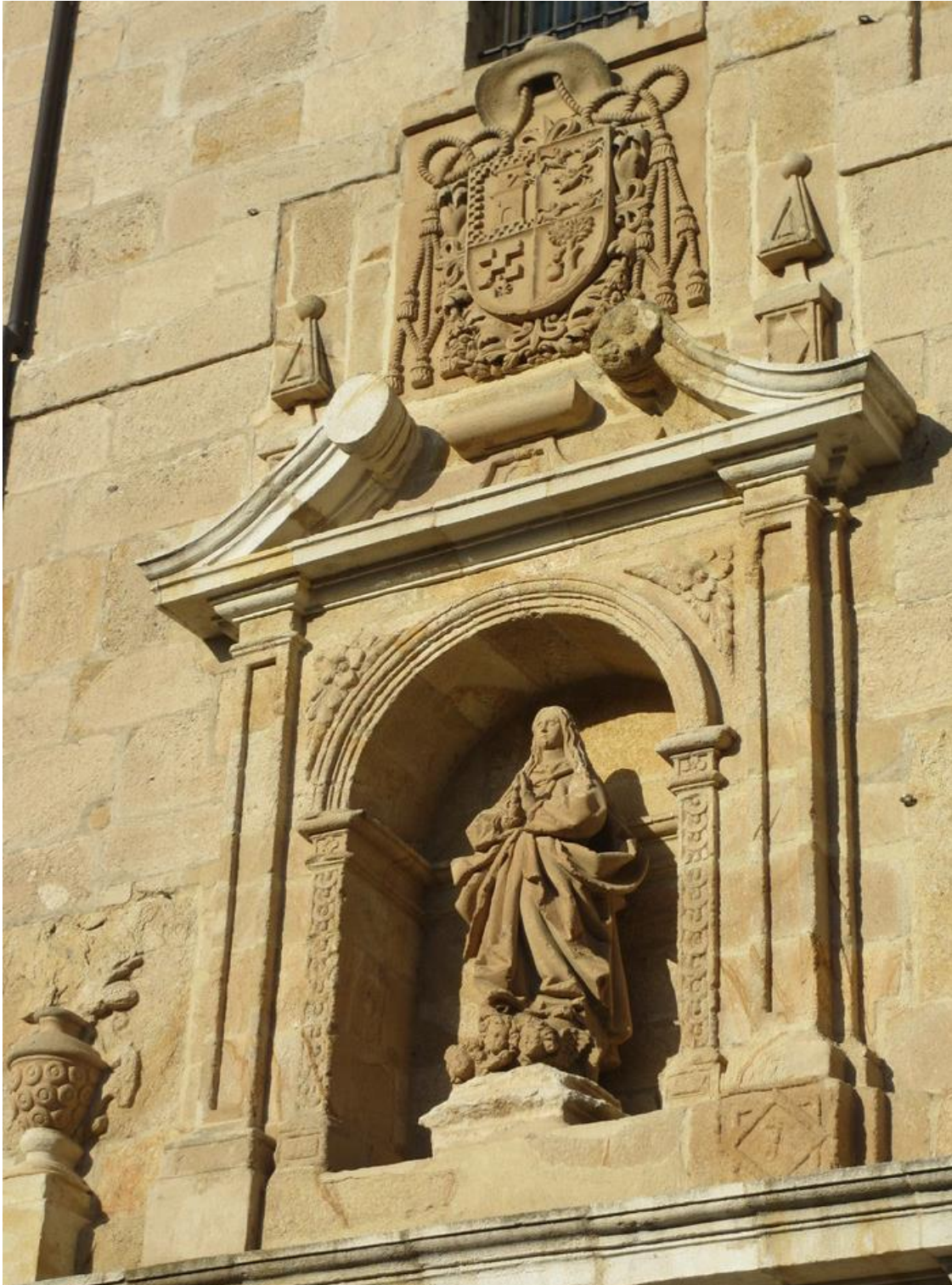
Sección de la portada de la iglesia del convento de la Concepción de Zamora, reformada a expensas del obispo Salizanes en 1671 para tener en su altar mayor su patronato y entierro, idea que se corrigió cuando es destinado a Córdoba y construyó su nueva capilla funeraria en la Mezquita-Catedral. Se puede ver el escudo del prelado superando el frontón, idéntico a los ejemplos de Córdoba.
