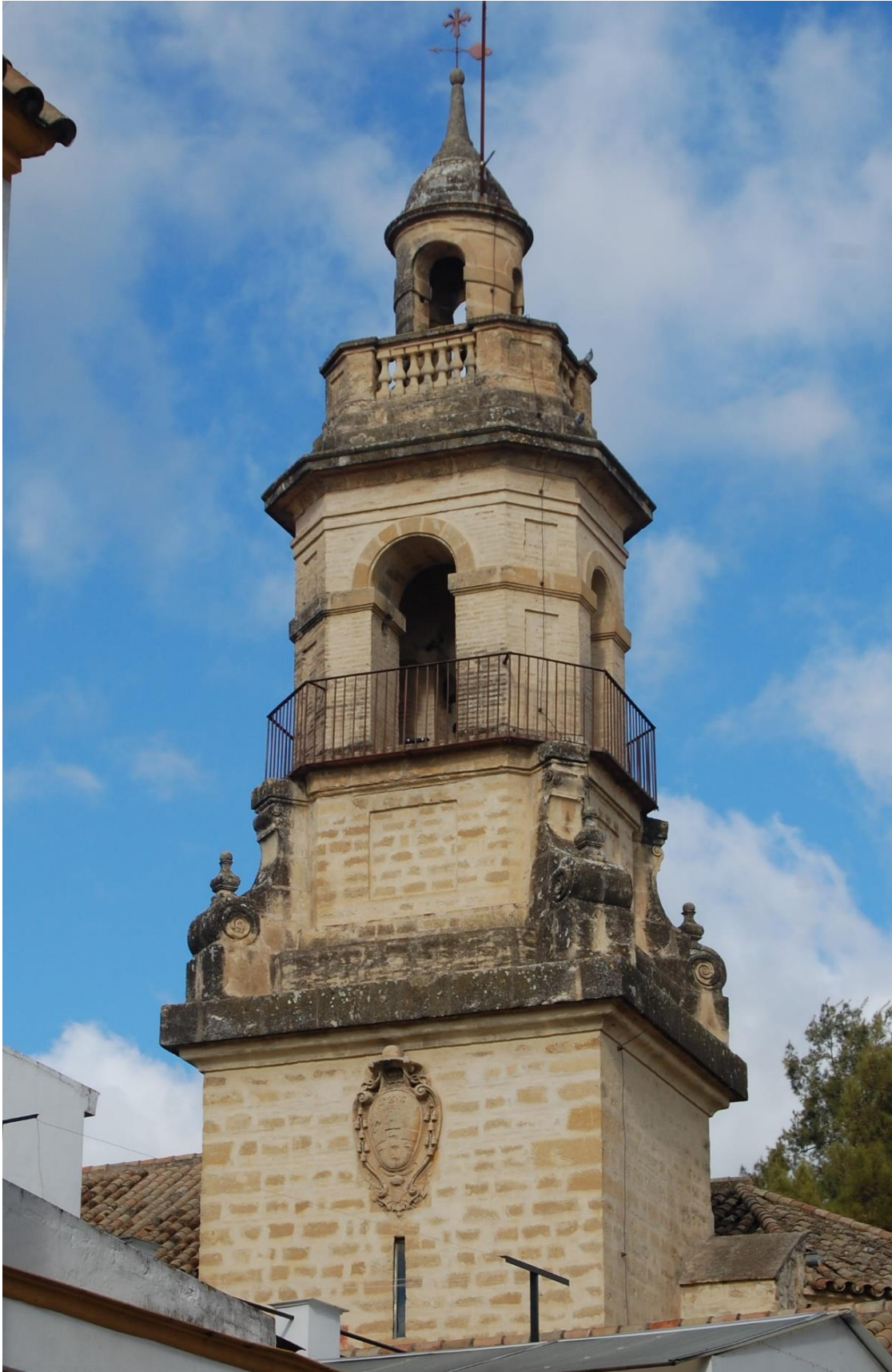
Torre de la iglesia de la Magdalena, cuyo anterior campanario “fue derribado siendo obispo de Córdoba el ilustrado señor don Antonio Caballero y Góngora, para sustituirlo con la actual que nada tiene de gallardana ni de gusto en su arquitectura”, según Ramírez de Arellano.
