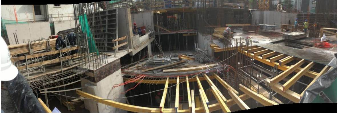
Fotografía D.4: En esta fotografía se puede apreciar el evidente desorden de la cuadrilla de moldaje.
