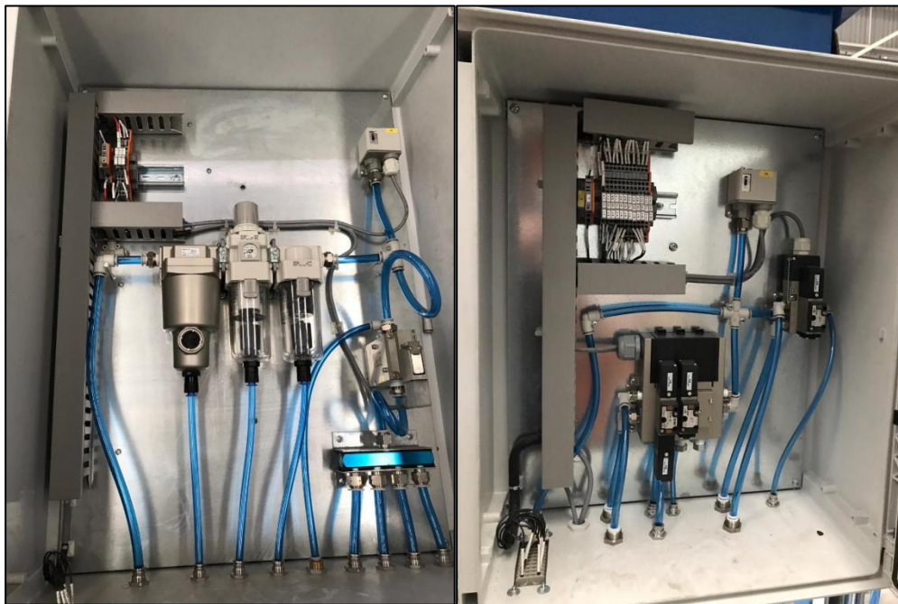
Ilustración 17 Tablero de distribución neumático principal (izquierda) y de sistema de homogenización (derecha).
