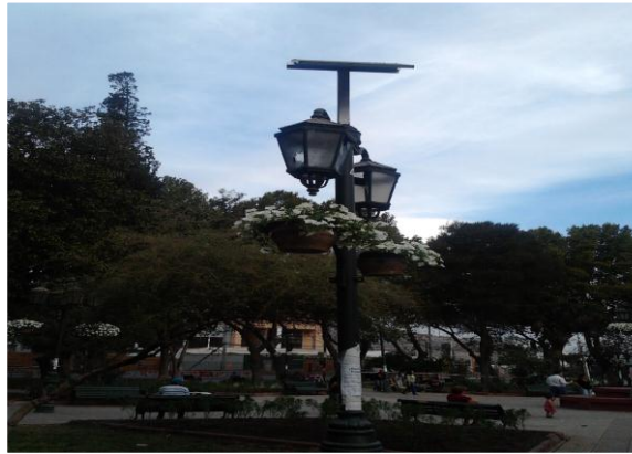
Figura 3.9: Postes de alumbrado [Fuente: elaboración propia (2013)]
