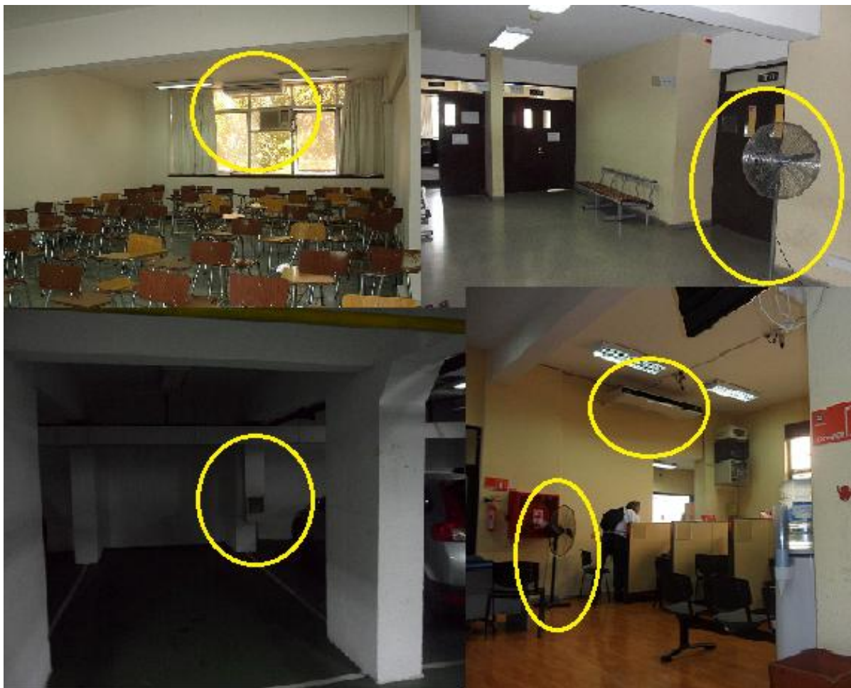
Figura 3.6.- Sistemas de climatización y ventilación del edificio
