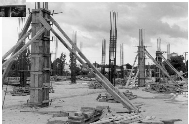
Preparación de encofrado de losas, con solera o piso de chapones metálicos modulares, y banquinas y puntales de madera maciza
