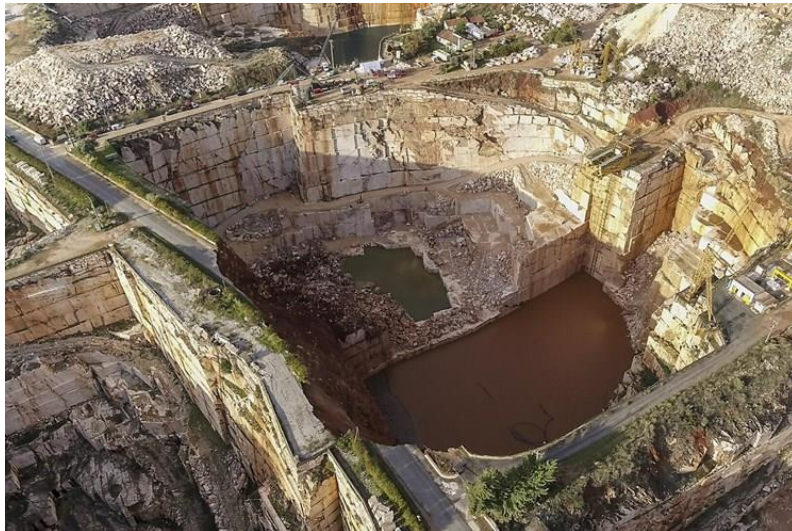
Figura 1.2 - Colapso de um troço da Estrada Municipal 255 entre Borba e Vila Viçosa em 2018 (Fonte: LUSA)
