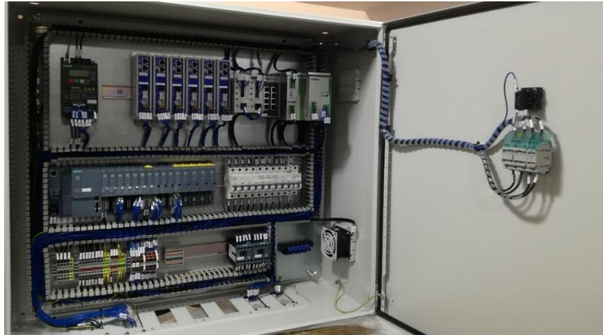
Figura 109. AG38-BJHT - Quadro elétrico
