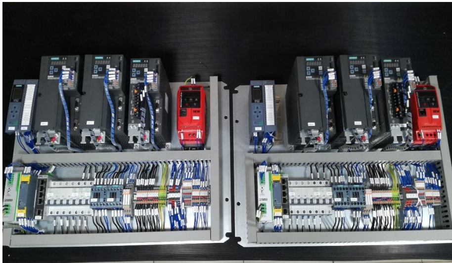
Figura 117. AG16-MG - Quadro elétrico
