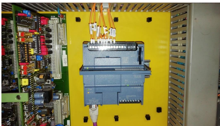
Figura 73. Montagens elétricas do projeto AM11
