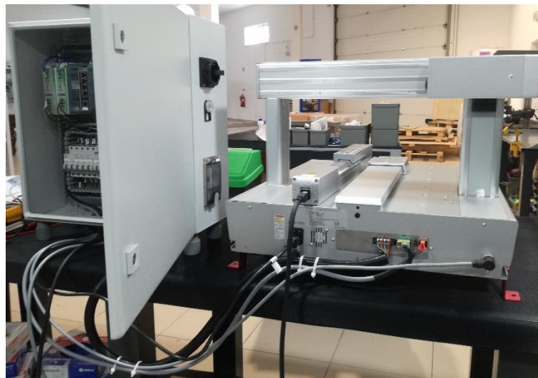
Figura 45. Eletrificação dos equipamentos externos ao quadro elétrico
