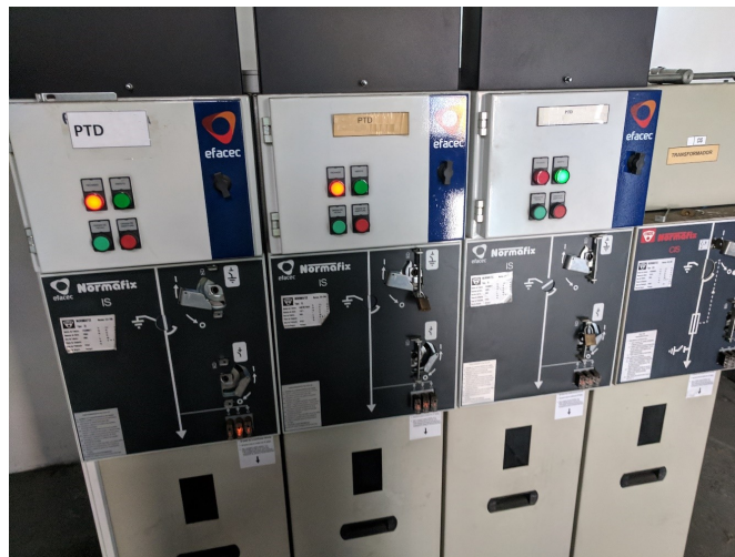
Figure 3.15: Celas de média tensão pertencendo a um PT
