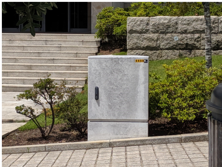
Figure 3.19: Armário de Distribuição
