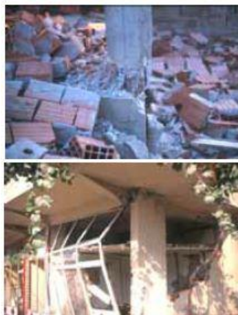
Fig. 8 – Rotura em pilares por flexão [21].
