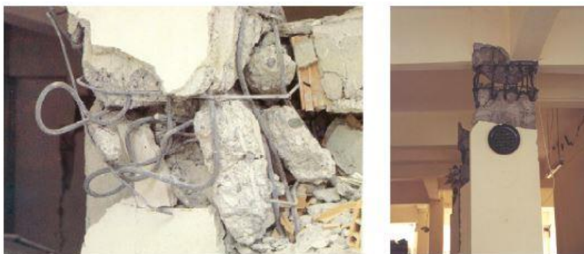
Fig. 6 - Pilares de betão armado com inadequado confinamento [20].
