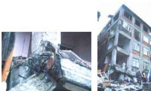
Fig. 9 – Resistência inadequada ao corte em nós [21].
