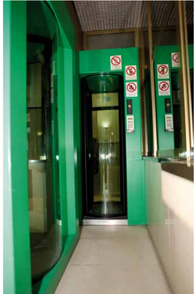
Leitores para abertura das portas, com banda magnética e dados biométricos, e portas de segurança de acesso à zona de alta segurança.
