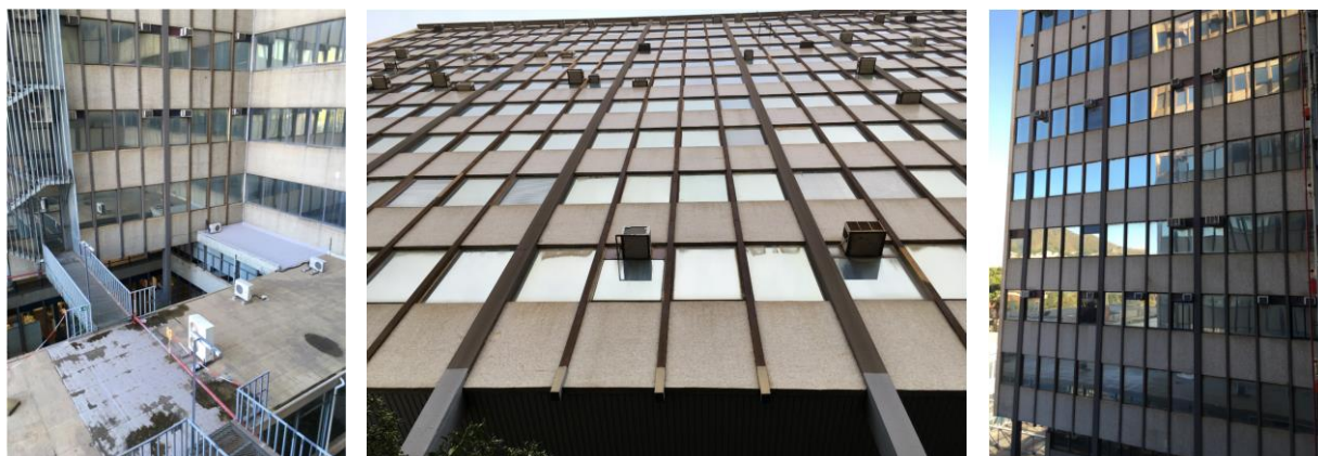
Figura 21. Distribución irregular de equipos de refrigeración.
