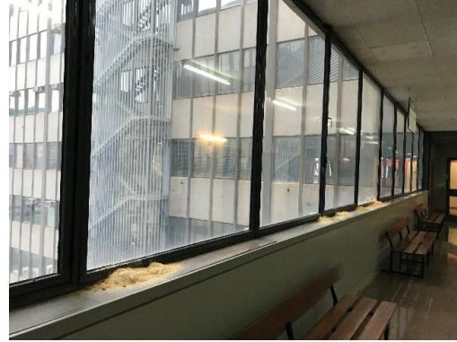
Figura 15. Filtración de agua por ventanas. Planta 8
