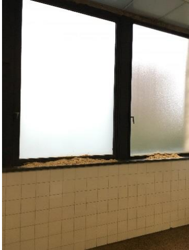
Figura 14. Filtración de agua por ventanas. Planta Baja
