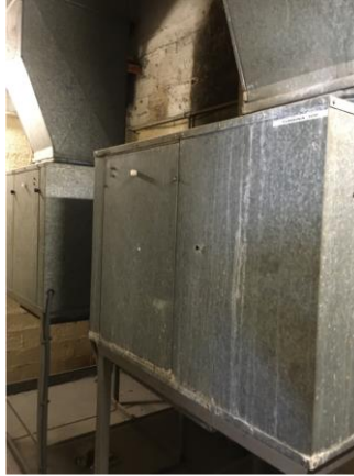
Figura 19. Par de turbinas por planta. Una por cada ala
