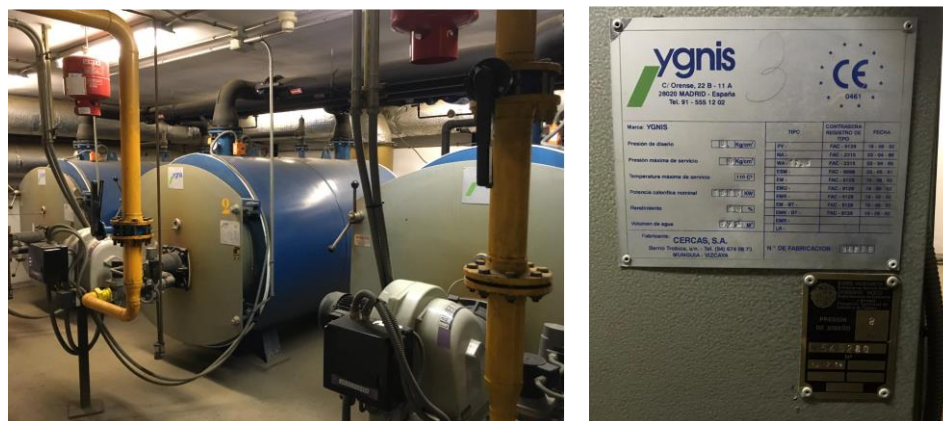
Figura 18. Batería de Calderas y Placa Técnica
