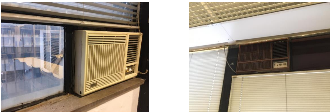
Figura 20. Equipos de refrigeración.
