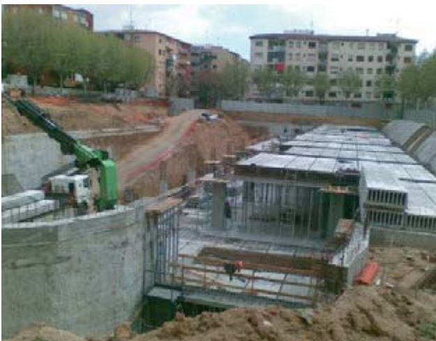
Figura 10. Vista de conjunt del sostre de la planta soterrani -1 abans de formigonar (Font: constructora)
