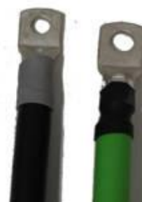
Figura 39: Cableado de baterías (Fuente: web de Autosolar)
