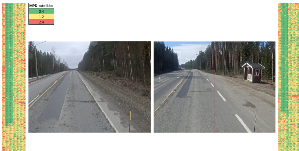
Kuva 2. Esimerkkikuva valuasfalttipaikasta SMA-päällysteellä (vasemmalla) ja AB-päällysteellä (oikealla). MPD-tulokset on esitetty noin 20 metrin matkalta ja molemmissa kuvissa on käytetty samaa väriasteikkoa.
