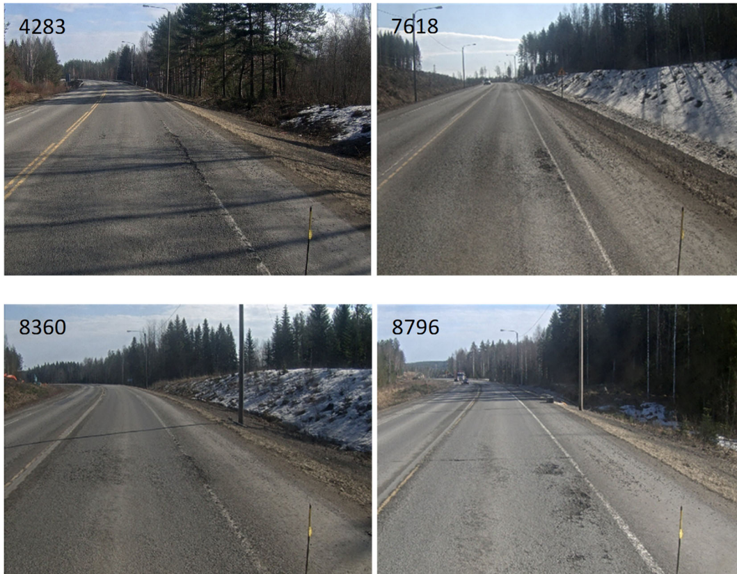
Kuva 16. PTM-mittauksen yhteydessä otetut kuvat kohteen C yhden tieosan taulukossa 3 esitetyistä karkeista ja purkautuneista kohdista.
