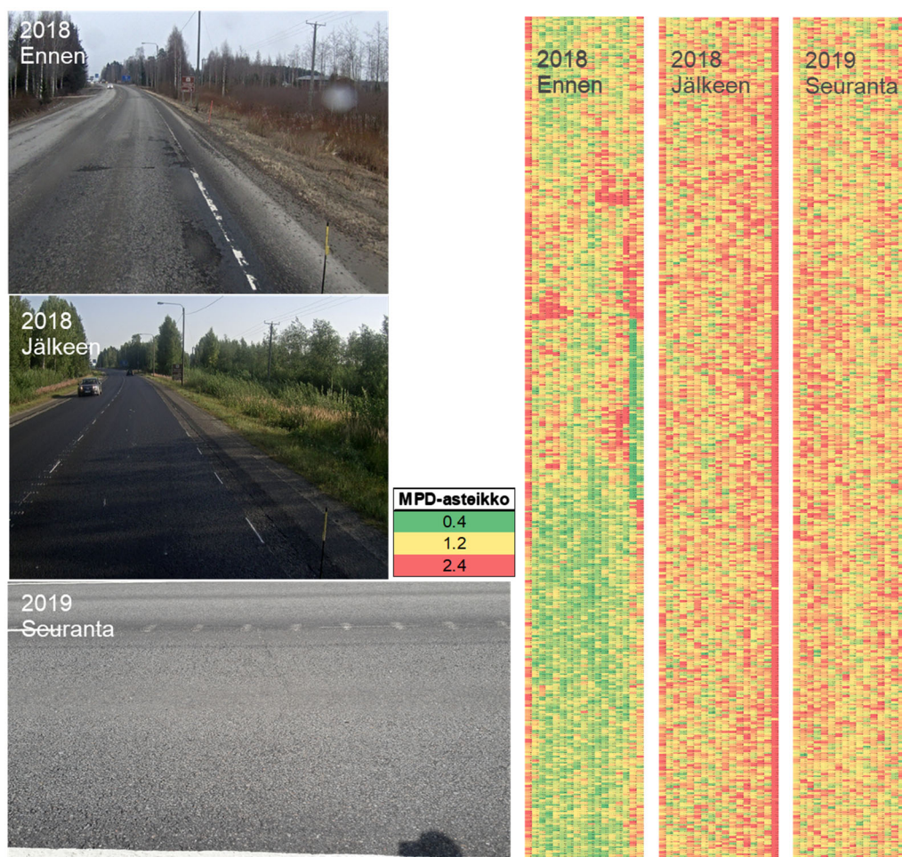
Kuva 22. Kohteen D yhdeltä tieosalta ennen päällystystä havaitun karkean kohdan seuranta. Vuoden 2019 valokuva on otettu maastokäynnin yhteydessä. Kuvan oikean reunan 10 cm MPD-tulokset ovat 40 m matkalta (Aet 4560-4600 m).
