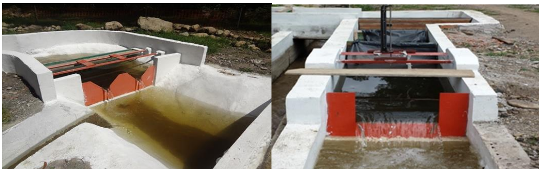
Figura 3.15 Vertederos para medición de caudales
