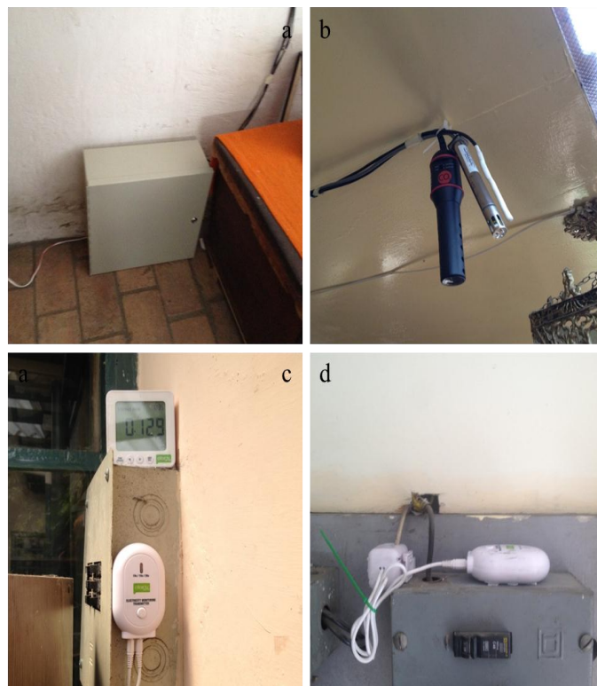
Figura 05: Equipos de monitoreo ambiental y cuantificación energética instalados en las viviendas estudiadas: (a)Caja de integración y procesamiento. (b) Sensores de humedad relativa, temperatura, radiación, concentración de CO 2 . (c) Monitor inalámbrico y transmisor. (d) Transmisor y sensor de electricidad.
