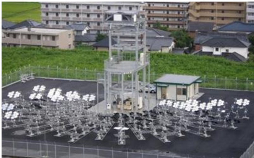
Ilustración 6: Central solar de Miyazaki con torre Beam-Down [7]
