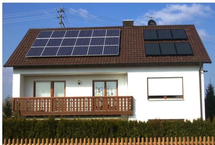
Ilustración 49: Paneles fotovoltaicos instalados en viviendas [39]
