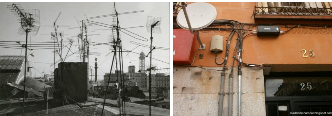
Figura 2.1 Tejado sin organización de antenas. [3] Figura 2.2 Fachada sin organización de cableado. [4]
