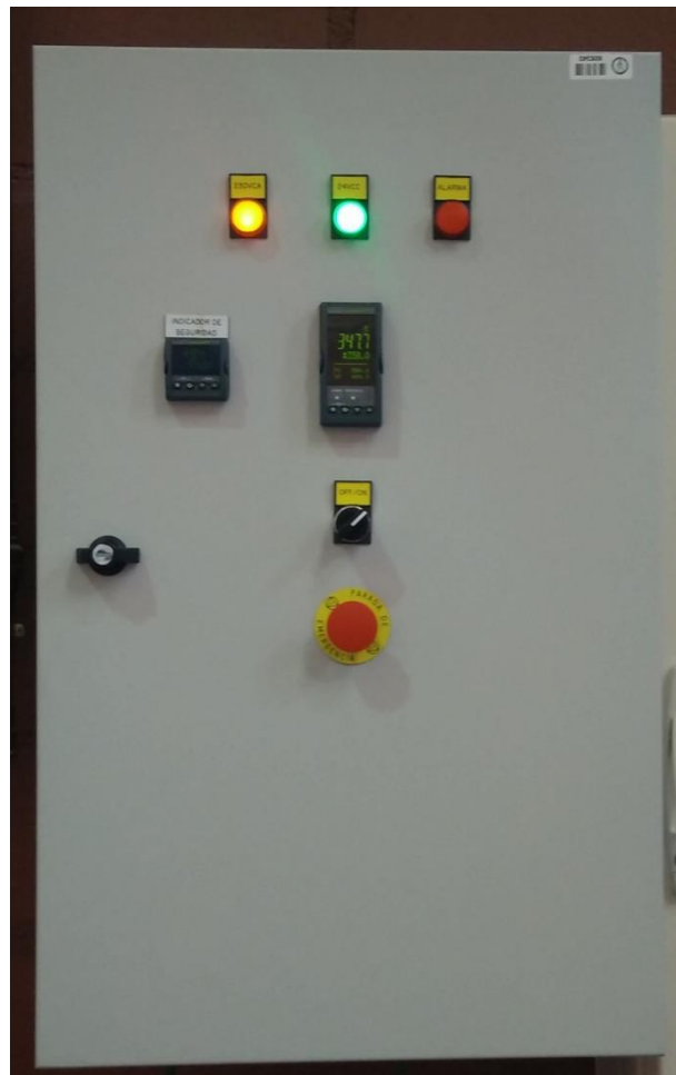
Ilustración 33. Cuadro de control de las resistencias del tanque
