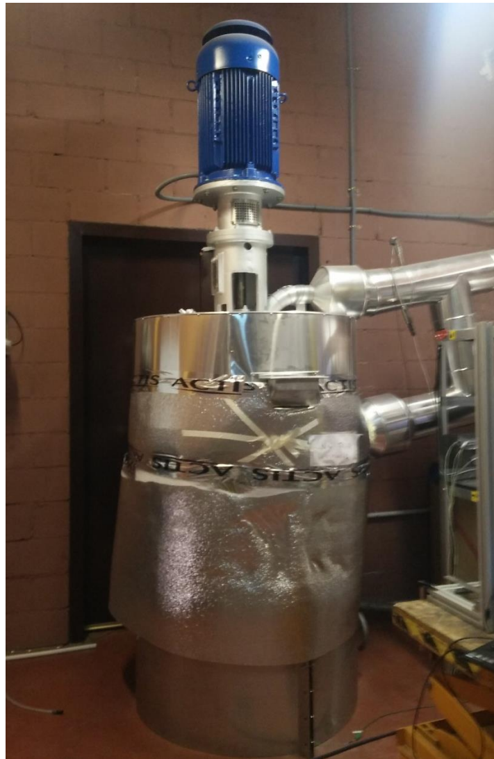
Ilustración 30. Tanque de sales y bomba
