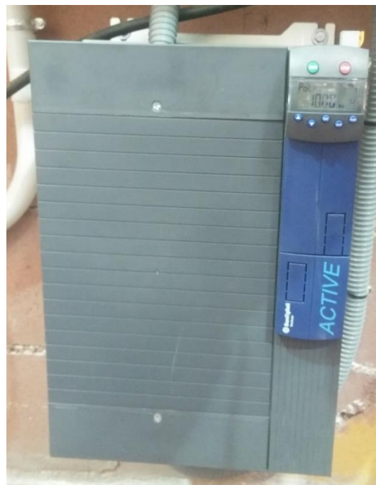
Ilustración 35. Variador de frecuencia
