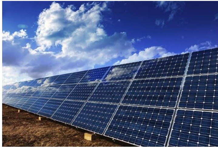
Ilustración 9. Paneles solares fotovoltaicos [38]
