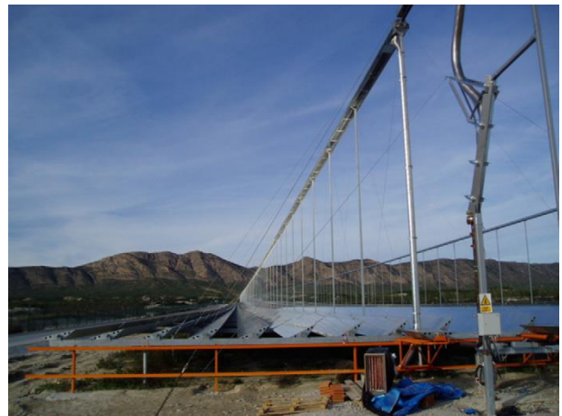
Ilustración 20. Central termosolar de espejos Fresnel [54]
