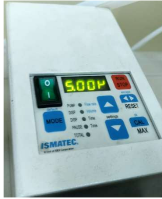
Figura 109: Inicialización de la bomba del suministro de metanol.
