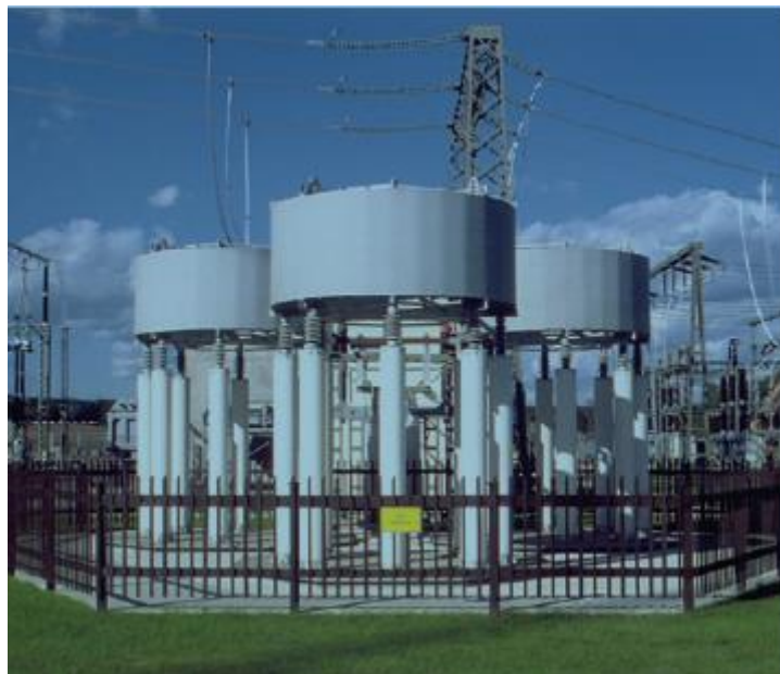
Figura 8: Reactancias shunt conectadas al terciario del transformador.
