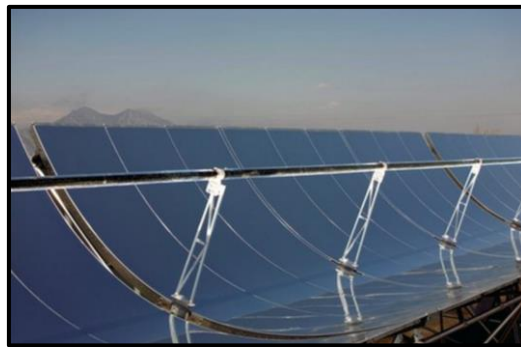
Figura 33. Reflector cilindro-parabólico y tubo absorbedor (Centro de energías Renovables - Ministerio de energía, Chile).
