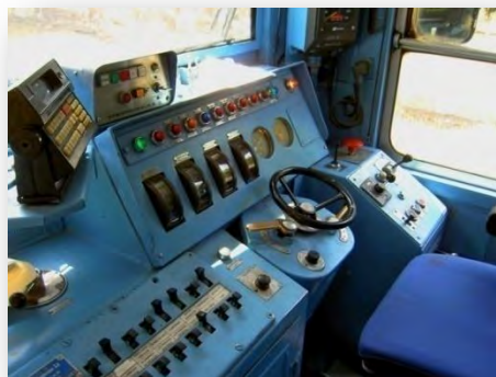
Figura 6.2. Vista de la cabina de la 269 reformada.
