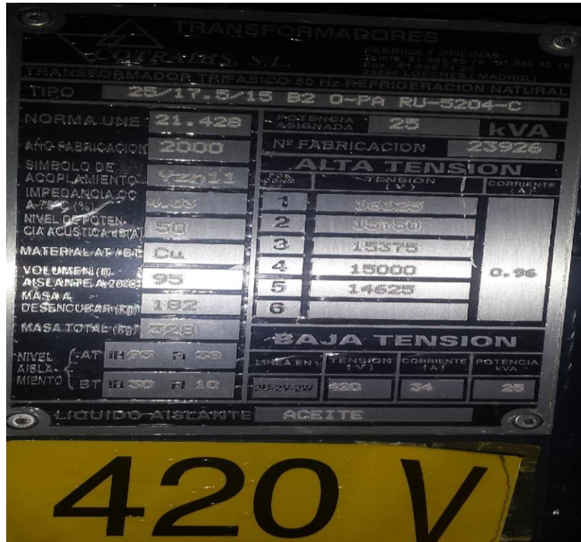
Figura 8.1: Placa característica del transformador ensayado en el Laboratorio de Alta Tensión [Foto propia].
