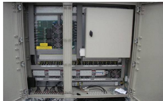
Figure 3: CREST / PE Power Monitoring Unit.
