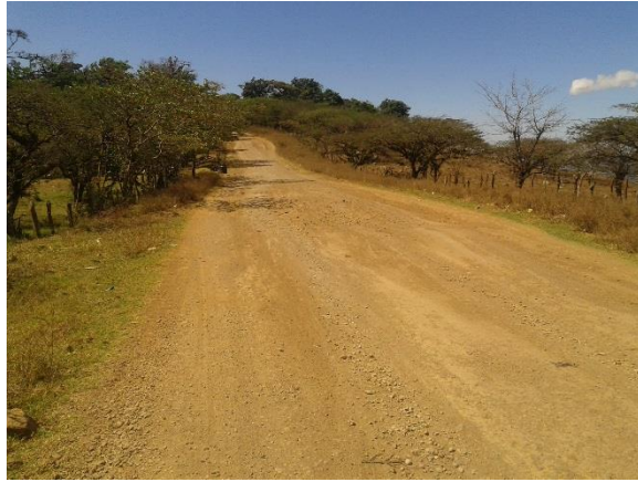
Ilustración N°5: Estado del camino Empalme El Regadío – Puente Gualilica. Fuente: Elaboración Propia
