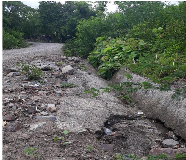
Ilustración N°6: Estado del camino Empalme El Regadío – Puente Gualilica. Fuente: Elaboración Propia
