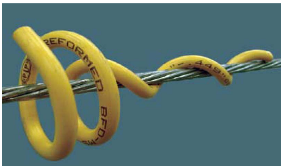
Figur 19. Såkalte "Plastic Bird Flight Diverters" er de mest benyttede merke metodene av faseledere og jordliner. Dette er en eller annen form for "spiral" som kan variere i farge og utforming avhengig av produsent.
