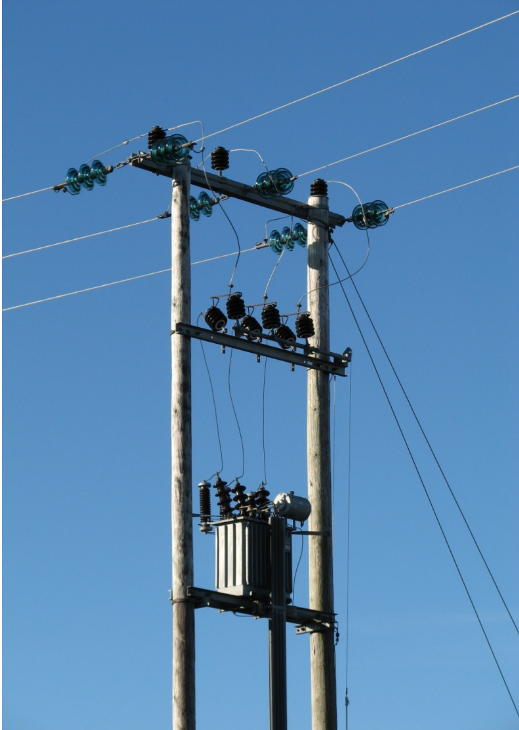
Figur 7. Stolpemonterte transformatorer i tilknytning til distribusjonsnettet er blant de strukturer som oftest forårsaker elektrokusjonsulykker hos fugl pga. de korte avstandene mellom strømførende ledninger og/eller strømførende ledning og jordet del. Foto: Kjetil Bevanger.
