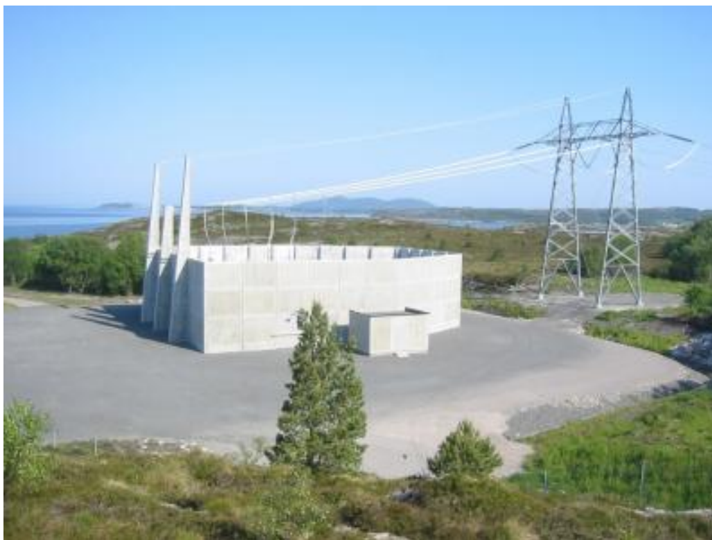
Figur 24. Der høyspentledninger enten går fra luftspenn til jordkabel eller omvendt, er det nødvendig å bygge såkalte muffestasjoner som beslaglegger et betydelig areal. Foto: Statnett.
