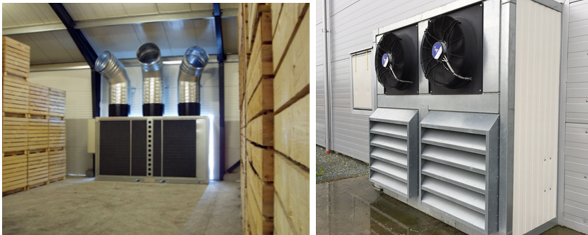
Figur 54. Kompakt kuldesystem for grønnsaklager. Inne-del med fordampere og kanalføringer (t.v.) og ute-del med kompressor-rom og kondensator (t.h.). Oppfuktingsdyser kan plasseres i kanalene som blåser luften opp og over kassene (Foto: Grimme Skandinavia AS).
