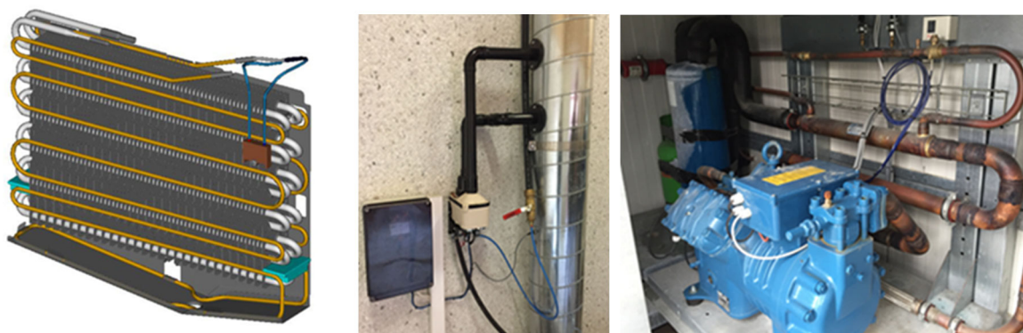
Figur 66. Avising av fordampere med bruk av elektriske varmekabler (t.v.), retur av varm glykol (midten) og retur av varmgass fra kompressor (t.h.)
