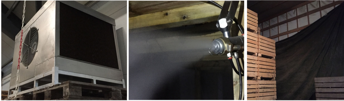
Figur 34. Ulike måter å oppfukte lagerluft: Gjennom oppfukning av membraner med vifte (t.v.), Tåke/dysespredning (midten), og oppfukning av store duker hengende på vegg (t.h.)
